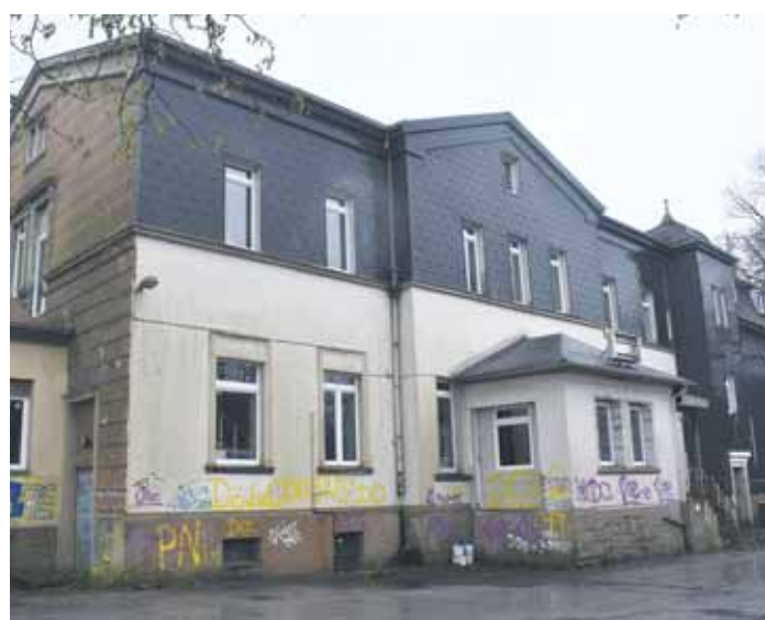
Auch die Straßenseite des Bahnhofsgebäudes gibt kein freundlicheres Bild ab. (Foto: Job)
