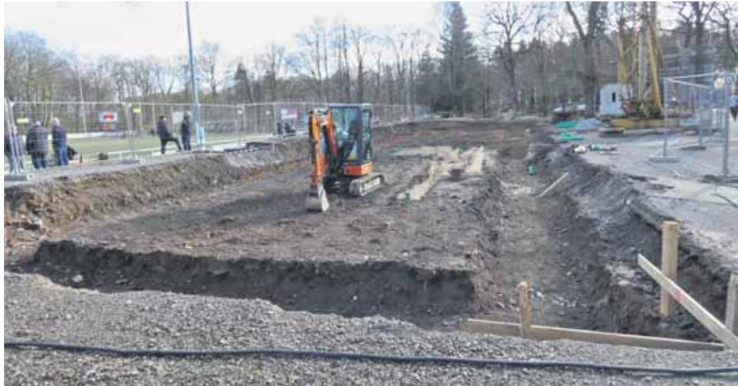
Auf dieser Aufnahme bekommt man einen guten Eindruck, wo genau das neue Vereinsheim entstehen wird. Mittlerweile ist das Fundament fertig und der Bau kann in die Höhe wachsen. (Foto: db)
