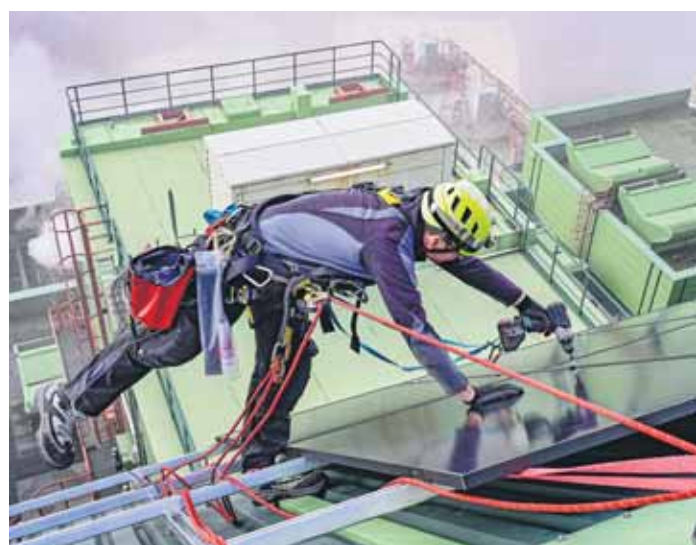
Signal vom Energiestandort Korzert: Industriekletterer machen die Montage von Solarpanels möglich. (Foto: AWG)
